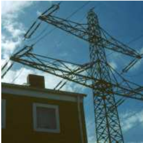
Hochspannungsfreileitungen können zu hohen magnetischen Dauereexpositionen führen.
