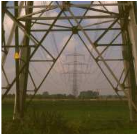
Oft werden auf einer Trasse Stromversorgungsleitungen verschiedener Spannungsebenen geführt.
