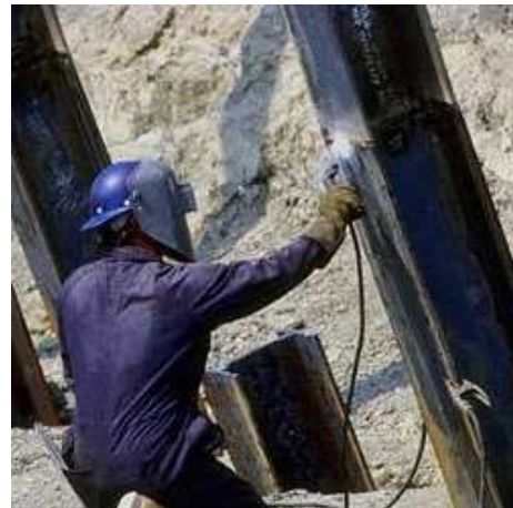
Beim Elektroschweißen treten sehr starke Magnetfelder auf.
