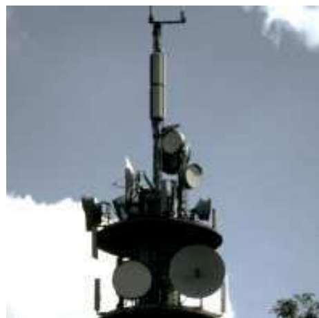
Parabolantennen sorgen für eine starke Bündelung der Abstrahlung von Richtfunkanlagen. Außerhalb des Hauptstrahls von Richtfunkstrecken ist die Intensität der Strahlung daher in der Regel sehr gering.
